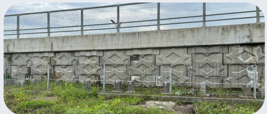
Gambar 13. Salah Satu Sensor SHMS Jembatan Kretek 2
