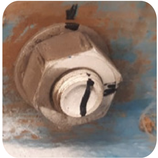
(10b) Kondisi garis torsi bergeser
