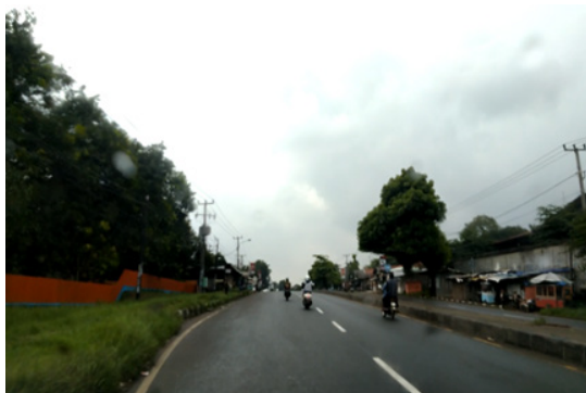
c). Kondisi Perkerasan LTBARAP-Halus pada Agustus 2020
