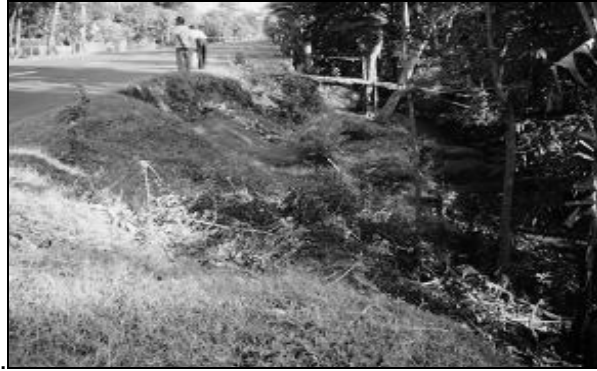
Gambar 3 Longsoran badan jalan
