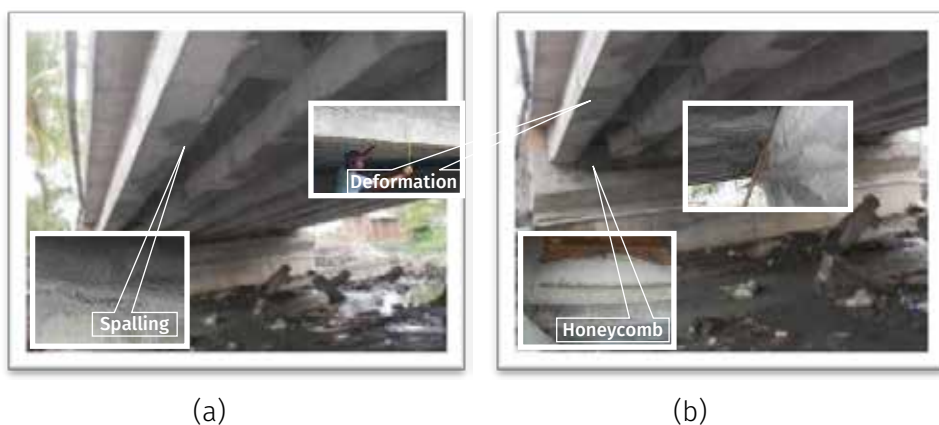
Gambar 4.7 Kondisi elemen Jembatan Matani: (a) Kerusakan pada Gelagar dan diafragma; (b) Retak ada abutment
