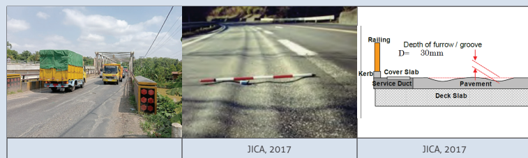
Gambar 49 Ilustrasi kode kerusakan 723 Lapis permukaan yang bergelombang dan alur dari jalur roda (rutting)
