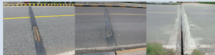
Gambar 58 Ilustrasi kode kerusakan 805 Bagian yang rusak/hilang
