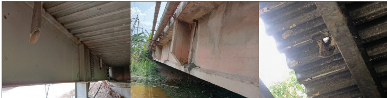
Gambar 44 Ilustrasi kode kerusakan 712 Tidak sesuai (hilang, kurang panjang)
