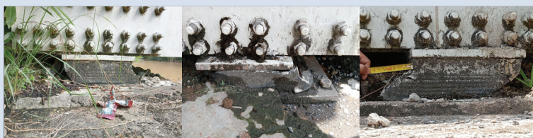
Gambar 64 Ilustrasi kode kerusakan 604 Perubahan (deformasi yang berlebihan)
