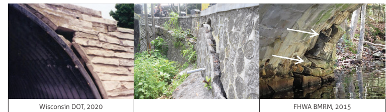
Gambar 4 Ilustrasi kode kerusakan 102 Dinding Pasangan yang menggembung
