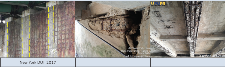
Gambar 10 Ilustrasi kode kerusakan 203 Karat baja tulangan
