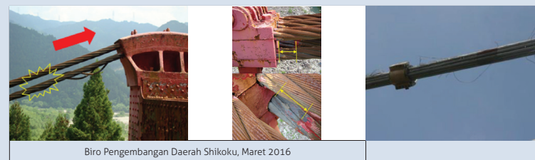
Gambar 19 Ilustrasi kode kerusakan 307 Kabel jembatan rusak (Biro Pembangunan Daerah Shikoku, Maret 2016)
