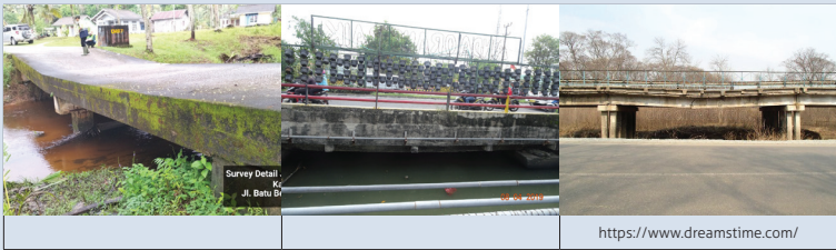
Gambar 13 Ilustrasi kode kerusakan 206 Defleksi
