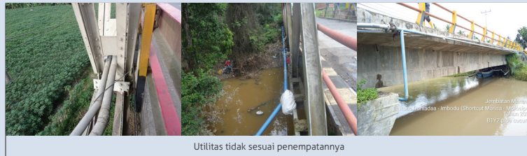
Gambar 70 Ilustrasi kode kerusakan 931 Tidak berfungsi, tidak sesuai penempatannya
