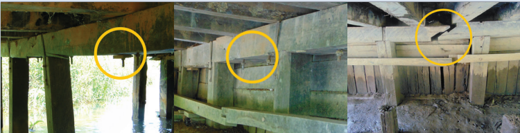
Gambar 29 Ilustrasi kode kerusakan 405 Sambungan yang longgar
