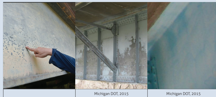
Gambar 14 Ilustrasi kode kerusakan 301 Penurunan mutu dan atau kinerja proteksi korosi (lapisan pelindung/cat)
