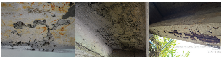
Gambar 7 Ilustrasi kode kerusakan 201 Beton keropos
