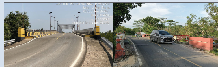
Penurunan jalan pendekat
