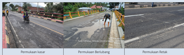
Gambar 48 Ilustrasi kode kerusakan 722 Permukaan yang kasar/berlubang (debonding, aus), Retak pada lapisan permukaan
