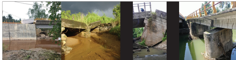
Gambar 40 Ilustrasi kode kerusakan 551 Kepala jembatan atau pilar bergerak
