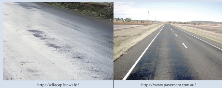
Gambar 47 Ilustrasi kode kerusakan 721 Permukaan licin
