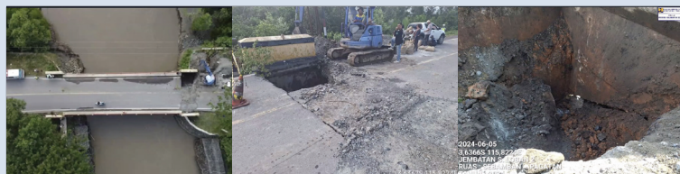
Gambar 31 Ilustrasi kode kerusakan 521 Pengikisan di sekitar kepala jembatan
