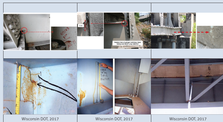
Gambar 17 Ilustrasi kode kerusakan 304 Retak (elemen baja dan las)
