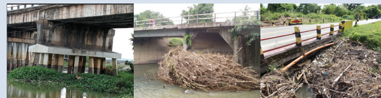
Gambar 37 Ilustrasi kode kerusakan 502 Penumpukan debris dan hambatan aliran sungai
