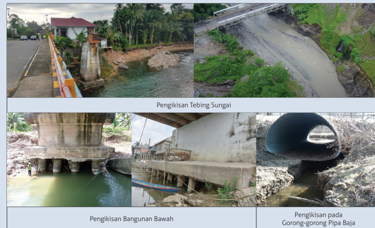
Gambar 38 Ilustrasi kode kerusakan 503 Pengikisan di sepanjang aliran sungai
