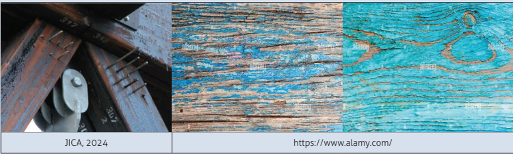
Gambar 28 Ilustrasi kode kerusakan 404 Penurunan mutu pelindung permukaan
