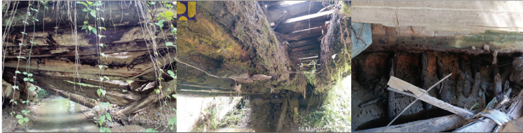
Gambar 21 Ilustrasi kode kerusakan 401 Lapuk
