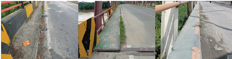
Gambar 43 Ilustrasi kode kerusakan 711 Pipa cucuran dan drainase yang tersumbat
