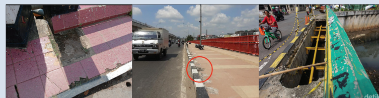
Gambar 52 Ilustrasi kode kerusakan 732 Lubang pada trotoar
