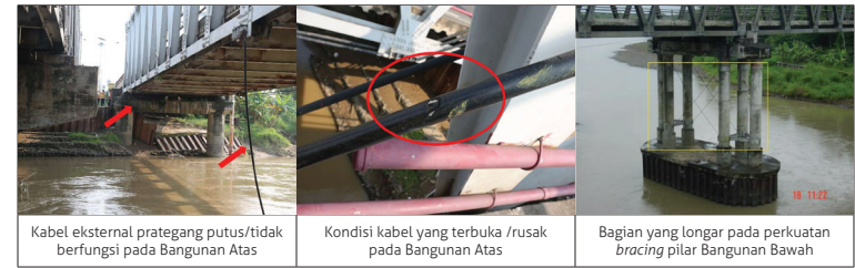
Gambar 41 Ilustrasi Kode Kerusakan 561 untuk Bangunan atas dan bangunan bawah yang longgar, hilang, rusak atau tidak berfungsi
