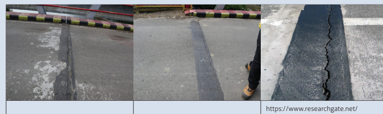
Gambar 59 Ilustrasi kode kerusakan 806 Retak aspal akibat pergerakan sambungan (tipe asphaltic plug joint)
