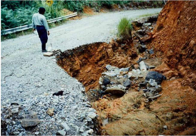
Gambar 5.16 Kerusakan Jalan Akibat Gerusan Saluran Tepi
