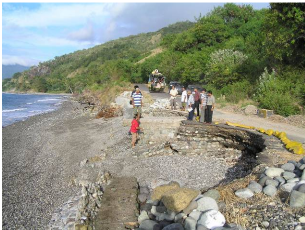
Gambar 5.19 Longsoran Badan Jalan Akibat Abrasi Pantai
