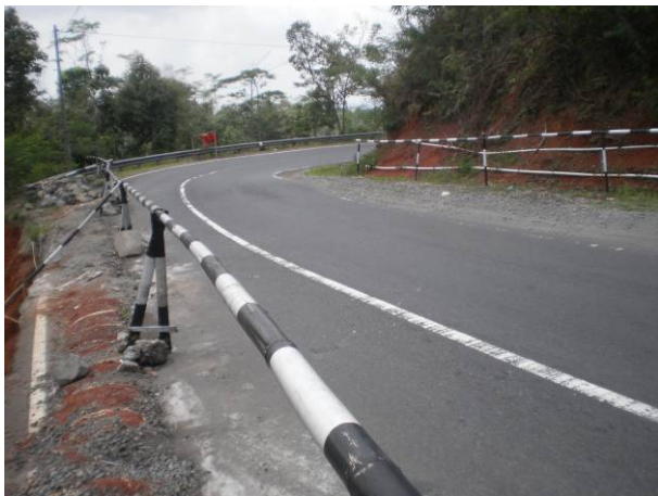
Gambar 4.25 Pergeseran Badan Jalan ke Tebing
