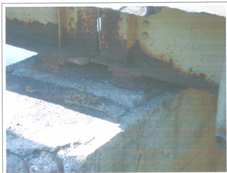
Gambar 4.9 : Gelagar berkarat di atas Pilar Jembatan Bangkaderes B
