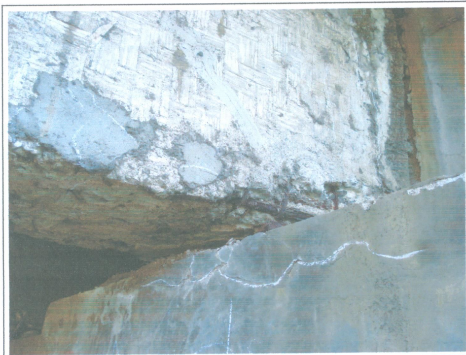
Gambar 4.6 : Retak Struktural pada Gelagar dan Abutmen Jembatan Pengarengan I A
