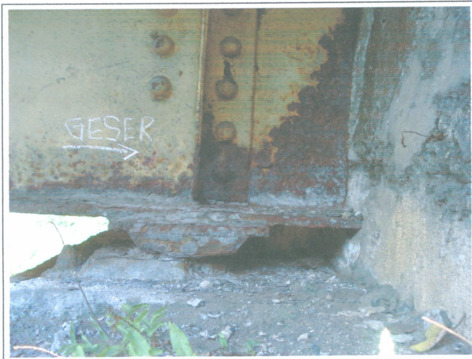
Gambar 4.8 : Pergeseran Gelagar Jembatan Bangkaderes B
