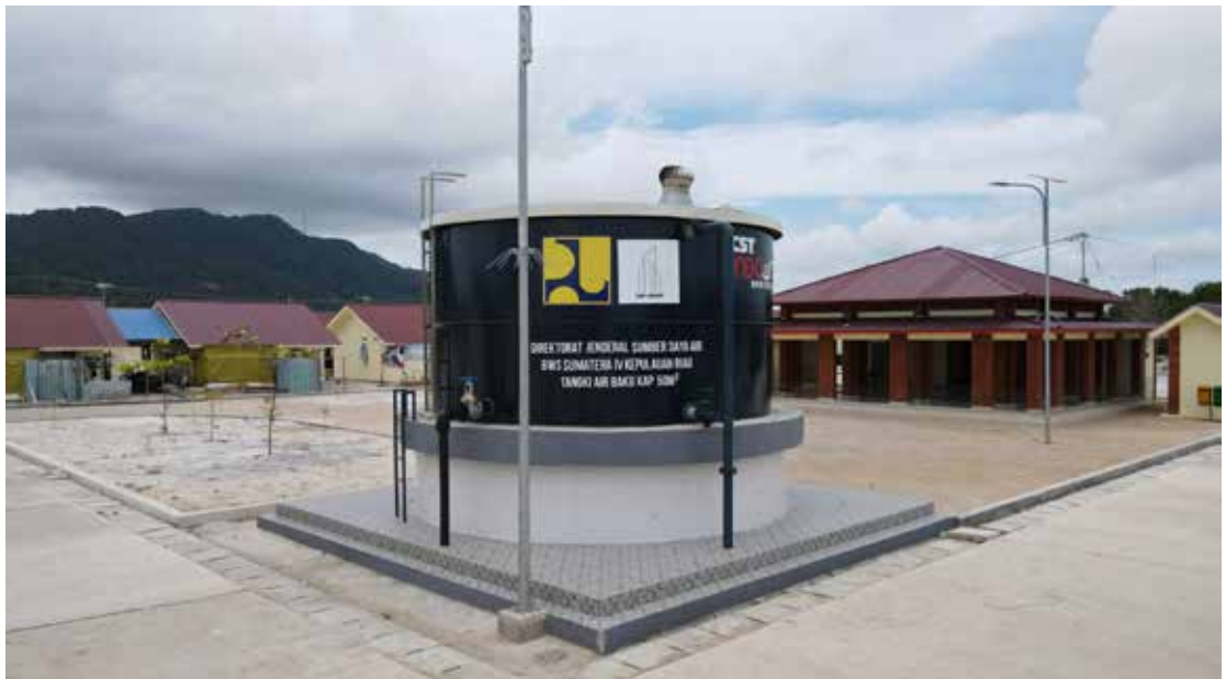
2.13-14 Rumah pompa & reservoir di kawasan Huntap. Sumber: BWS Sumatera IV
