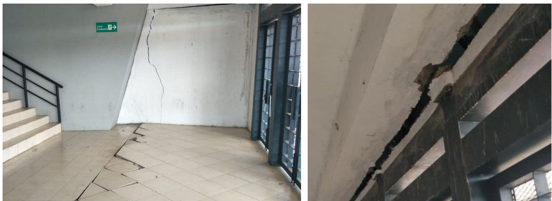
Gambar 13 Kerusakan pada struktur pendukung mengakibatkan pergerakan antara struktur utama dan pendukung tidak bersamaan
