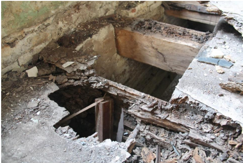
Gambar 83 Balok Girder (utama) mengalami pelapukan disertai dengan papan penutup lantai
