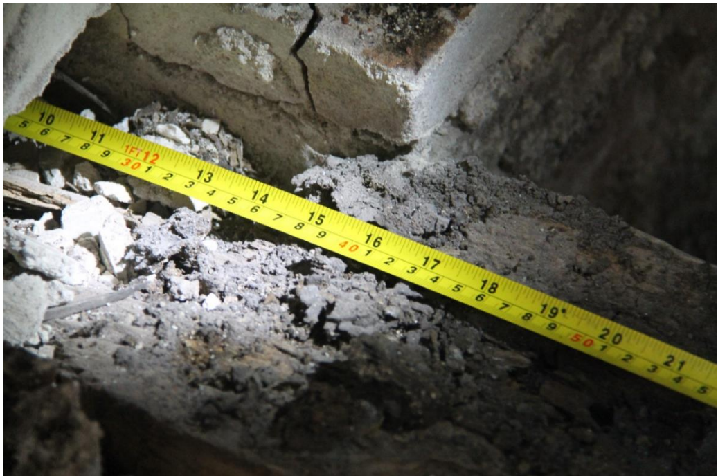
Gambar 86 Kerusakan balok pada sisi tumpuan, bidang tumpuan adalah sebesar 40 cm
