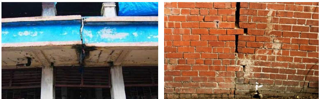
Gambar 8 Retak pada bagian tengah bangunan
