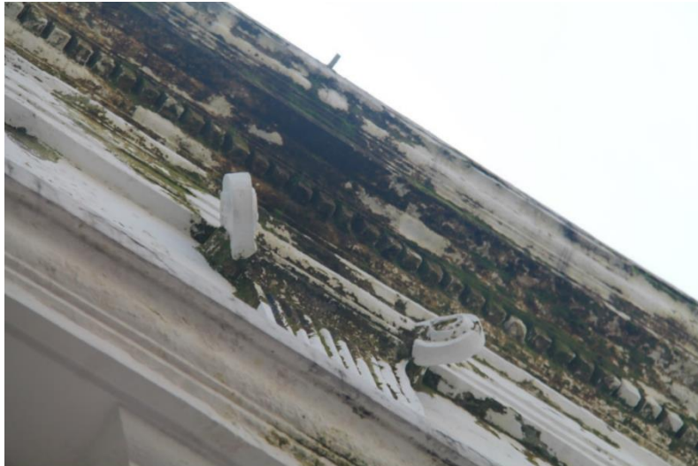
Gambar 64 Kerusakan dinding akibat lumut
