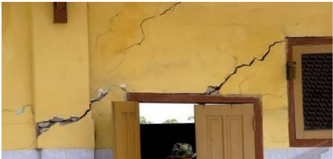
Gambar 21 Retakan pada kolom dan dinding
