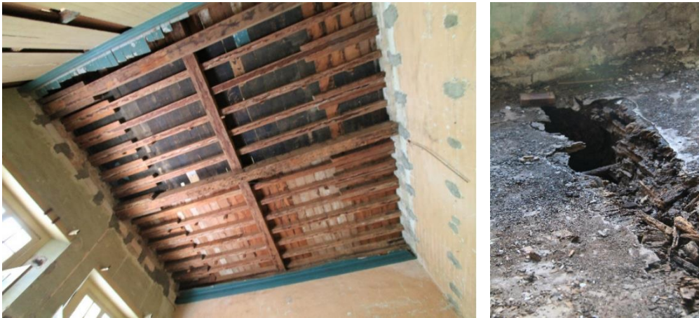
Gambar 76 Pola pembalokan lantai dan jenis pelapukan pada tumpuan, dan eks. ruang kamar mandi
