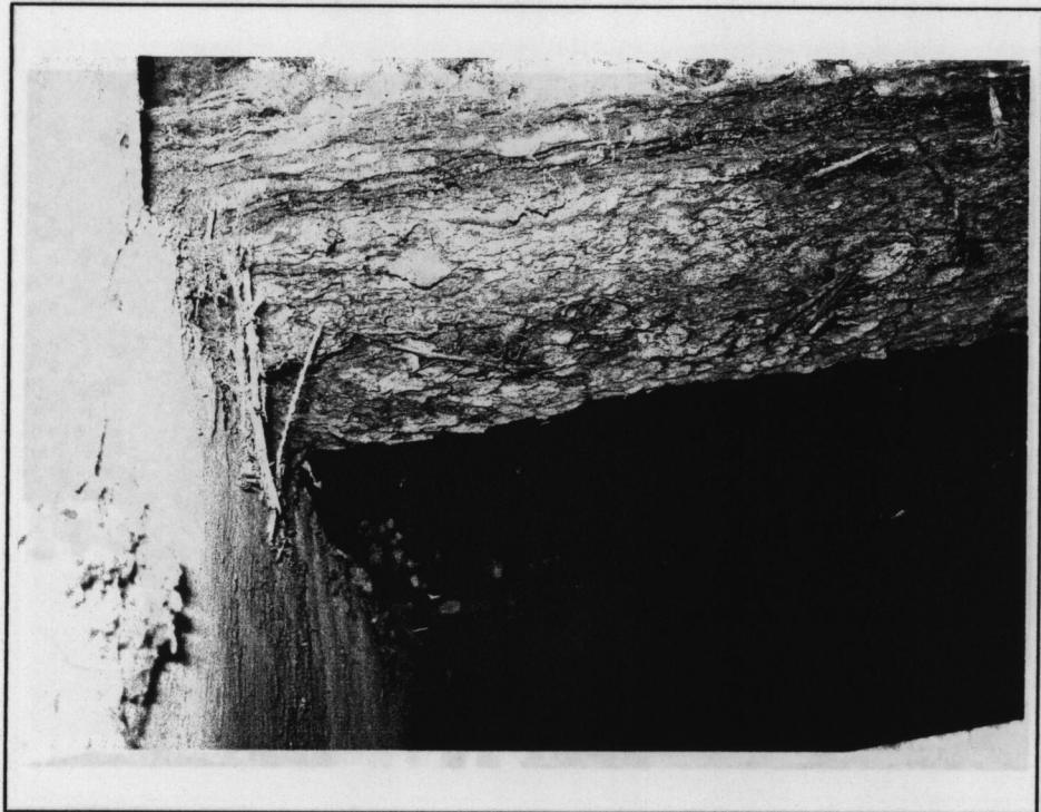
Gambar 4.12 : Gelagar berkarat Jembatan Rohana B
