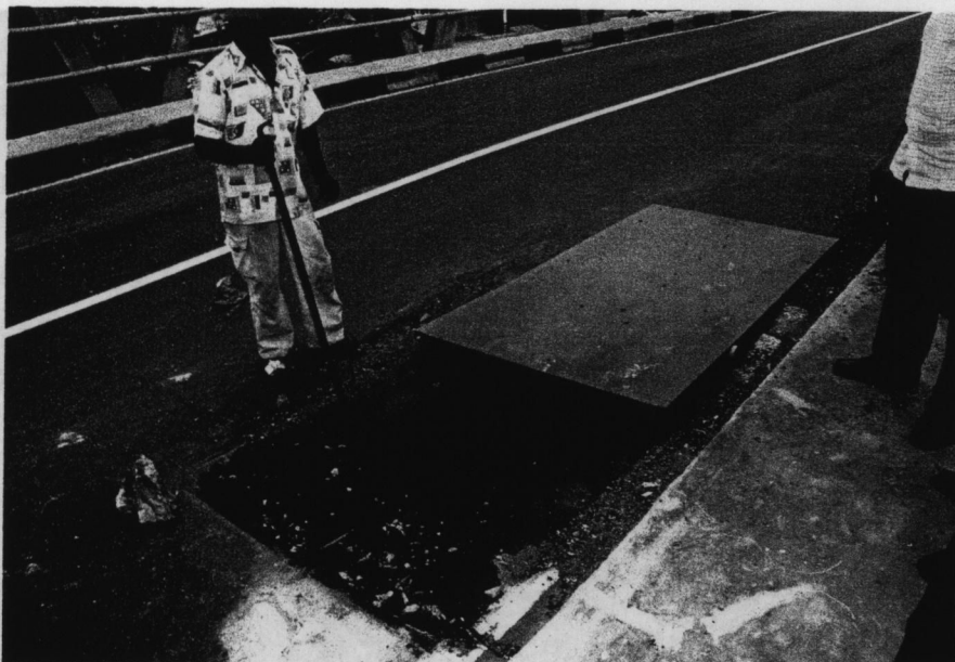
Gambar 4.4 : Kerusakan aspal dan lantai pada Jembatan K. Bodri A
