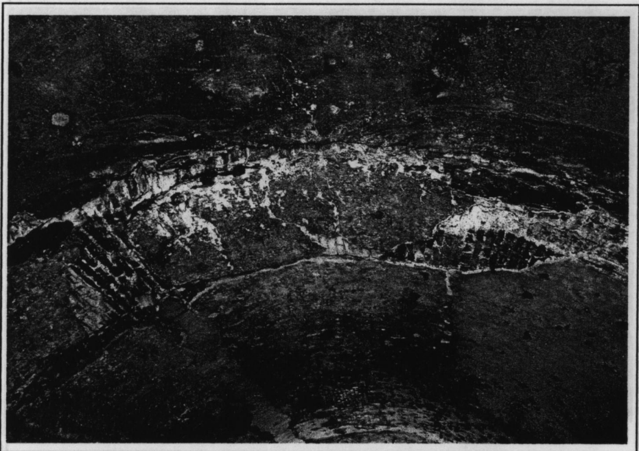
Gambar 4.11 : Kondisi struktur utama plengkung Jembatan Jurang Jero
