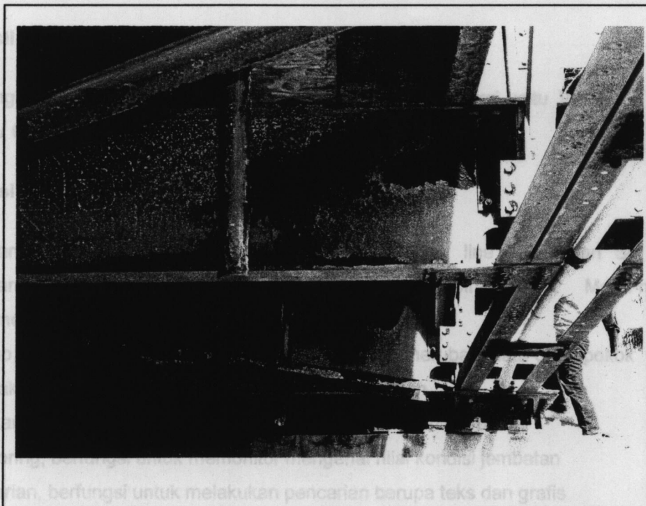
Gambar 4.17 : Cross beam berkarat pada Jembatan Bogor Kerep
