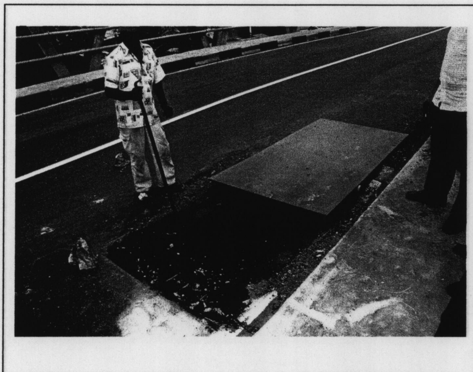
Gambar 4.6 : Kerusakan aspal dan lantai pada Jembatan K. Bodri A
