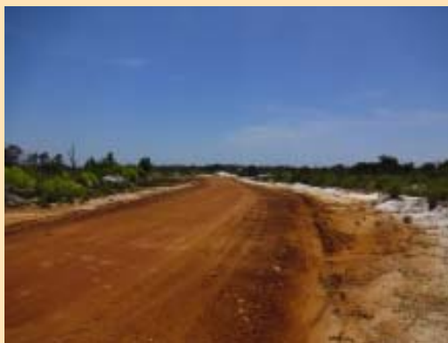
Kondisi Bahu pada Timbunan Tanah
