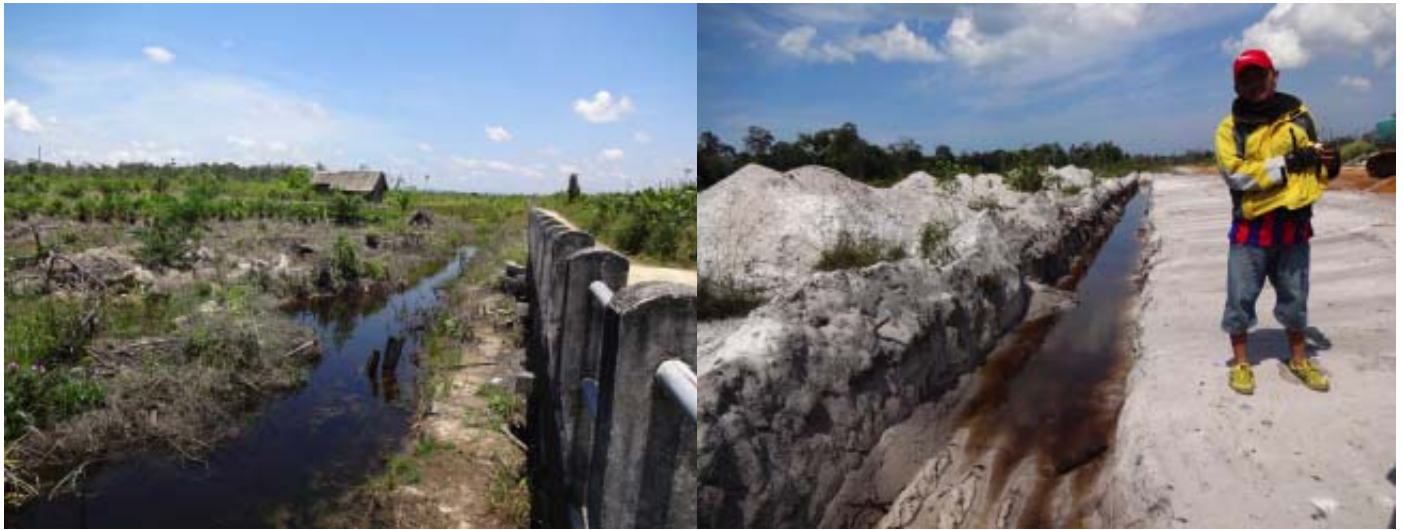
Gambar 4 8 Genangan Air Berwarna Kecoklatan di Sisi Badan Jalan Pada Ruas Jalan Ceremai - Temajuk, Kec. Paloh, Kabupaten Sambas
