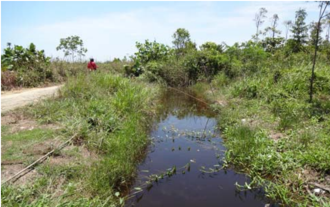
Gambar 4.14 Kondisi saluran samping di daerah cekungan alinemen vertikal pada Ruas Jalan Ceremai - Temajuk, Kec. Paloh, Kabupaten Sambas.
