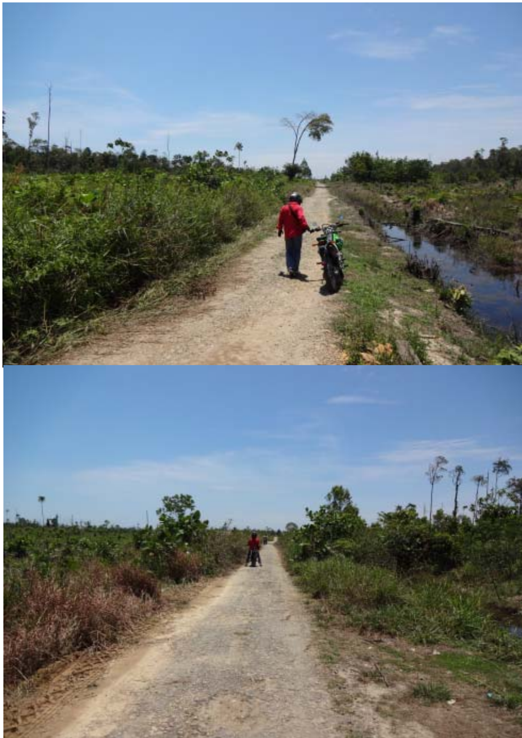
Gambar 4.13 Kondisi badan jalan pada Ruas Jalan Ceremai - Temajuk, Kec. Paloh, Kabupaten Sambas
