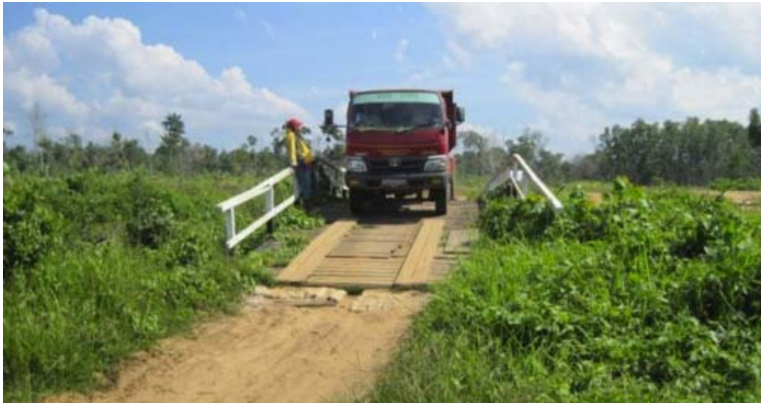
Gambar 4 11 Peningkatan Beban Lalulintas Dapat Mempercepat Kerusakan Jembatan
