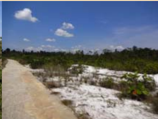
Kondisi Bahu pada Perkerasan Beton
