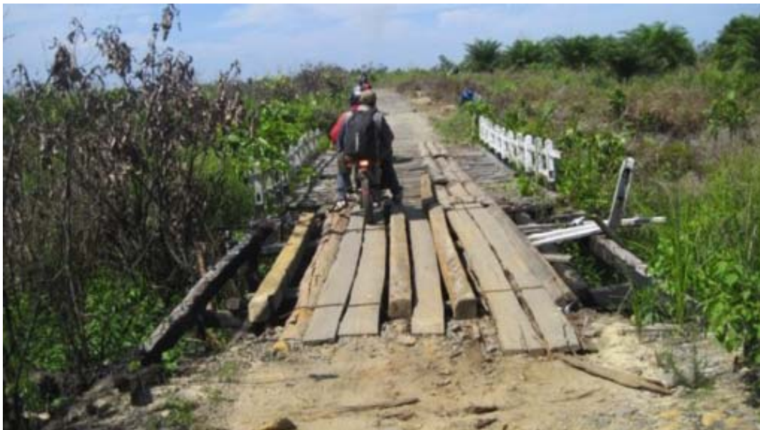
Gambar 4 12 Kerusakan Jembatan Kayu Akibat Semak-Semak Terbakar
