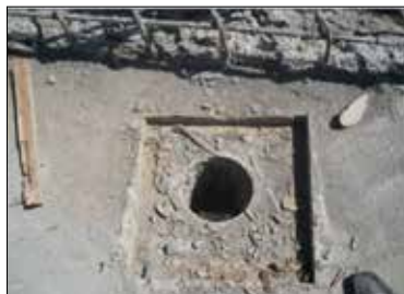
Gambar 4.22 Kondisi pipa drainase
