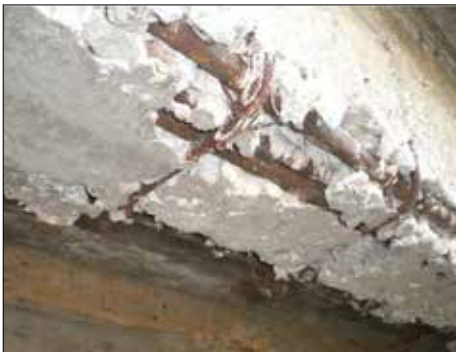
Gambar 1.2 Kerusakan Gelagar Jembatan Akibat Korosi
