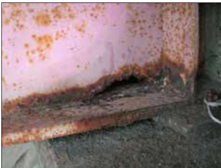
Gambar 1.3 Kerusakan Sistem Perletakan Jembatan Konvensional
