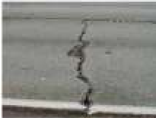
Gambar 39-a Ilustrasi spalling di sekitar joint
