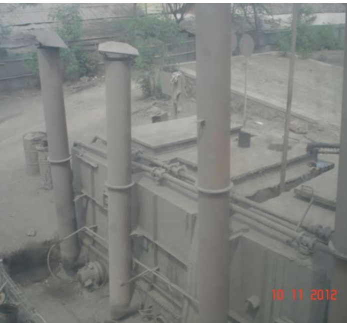
Gambar 3.10 Tangki Aspal Dengan Burner Pemanas Aspal
