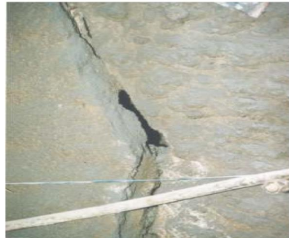
Gambar 5. Kerusakan shotcrete akibat swelling pada Batulempung (foto : A. Matejcek)
