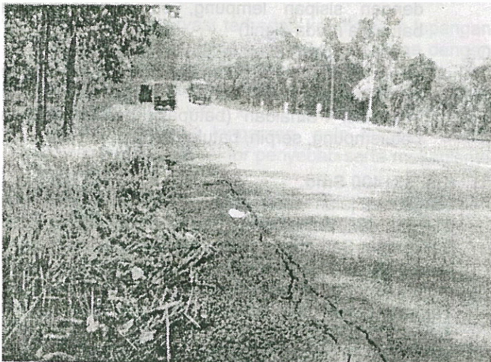
Foto 2. Bahu dan badan jalan yang retak, akibat longsor an lereng di bawah jalan pada km. 45+250 Smd.
