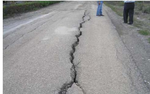
Gambar 3. Kerusakan pada ruas jalan Maubesi – Nesam
