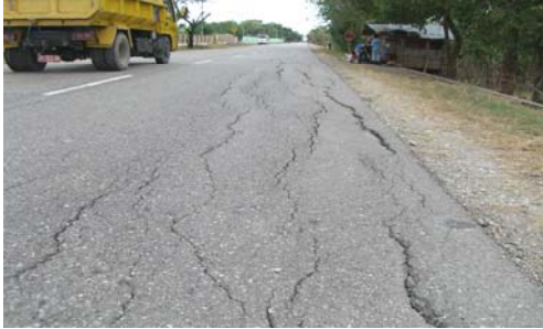
Gambar 2. Kerusakan pada ruas jalan Oesapa-Oesao-Bokong
