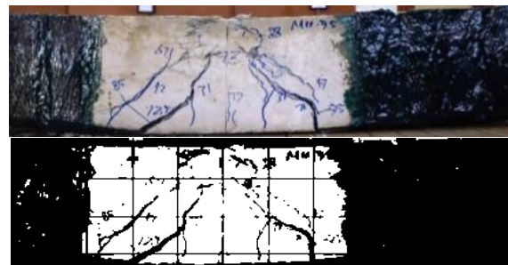
Pola Keruntuhan pada Beton yang dilapisi dengan CFRP 4 Lapis
