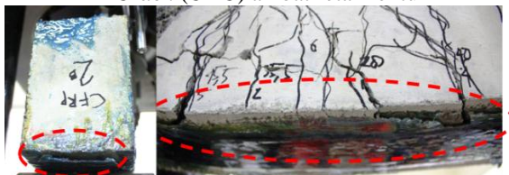
Lapis 2(b) Delaminasi FRP pada ujung FRP (Slip bonding) dengan Intermediate Crack (IC) akibat retak lentur
