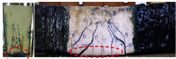
Lapis 4(b) Delaminasi FRP pada ujung FRP (Slip bonding) dengan Critical Diagonal Crack (CDC) akibat retak lentur
