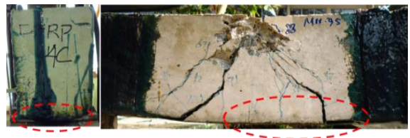
Lapis 4(b) Delaminasi FRP pada ujung FRP (Slip bonding) dengan Critical Diagonal Crack (CDC) akibat retak lentur
