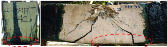
Lapis 4(c) Delaminasi FRP pada ujung FRP ( Slip bonding ) dengan Critical Diagonal Crack (CDC) akibat retak lentur
