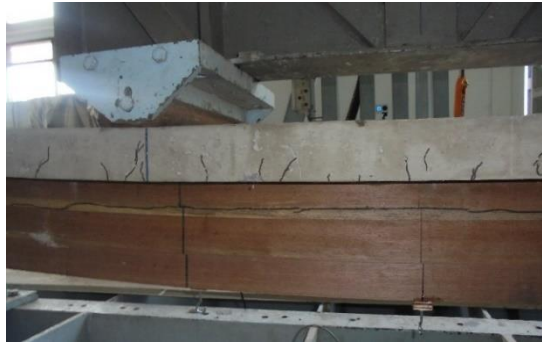
Gambar 4. Pola Retak Pelat Beton Balok Komposit
