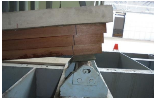
Gambar 6. Kerusakan Sepanjang Garis Perekat Balok Laminasi
