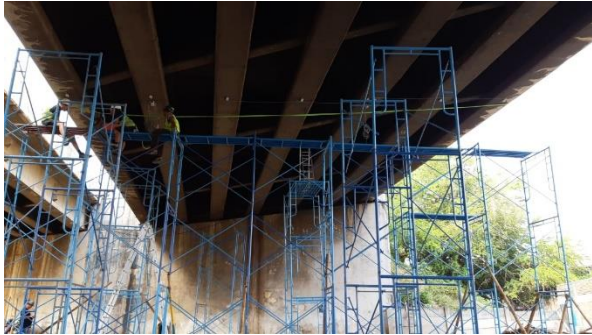
Gambar 5. Instalasi B-WIM di Jembatan Kaligawe (ID-004)
