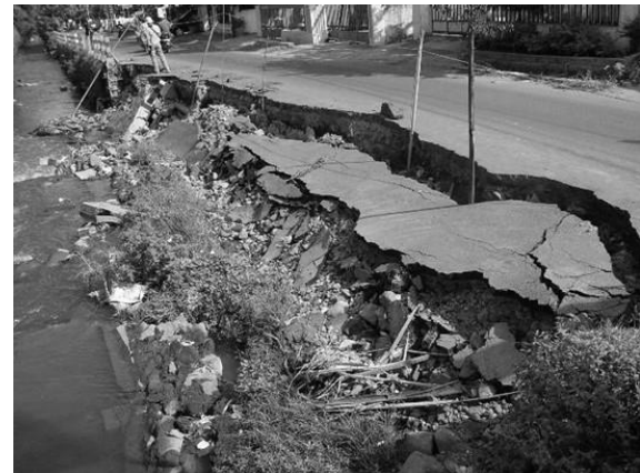
(b) lateral spreading pada sudut jalan
