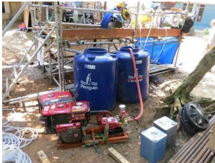
Gambar 12 - Dokumentasi pengaturan pompa
