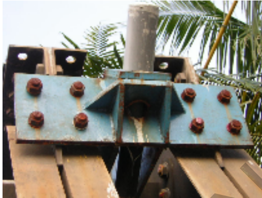
Gambar 3 Dudukan angker yang sudah berkarat baut-baut dan pelat bajanya serta pengecoran graut semen yang kurang rapih
