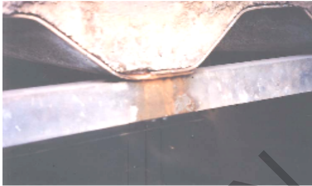
Gambar 30 Celah antara pelat baja bergelombang dengan bagian beton
