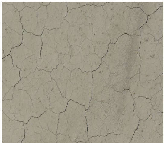
Gambar 5. Metode precrack dan tipikal jaringan retak rambut
