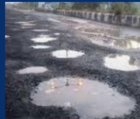
Gambar 2. Kondisi Jalan Berlubang (Sumber: detik.com)
