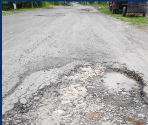
Gambar 1. Kondisi Jalan Rusak (Sumber: detik.com)
