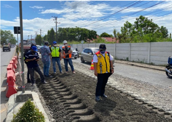
Gambar 2. Pemantauan Langsung Pengerjaan Metode CTB oleh Bambang Raharmad (Sumber: Dok. PPK 2.1 Prov. Kalsel, 2021)
