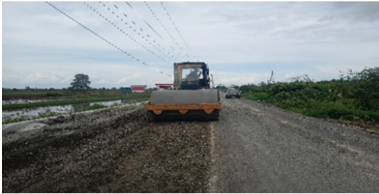
Gambar 6. Pemadatan akhir dengan Smooth Drum dan Pneumatic Tired Roller (Sumber: PPK 2.2 Prov. Kalsel, 2021)
