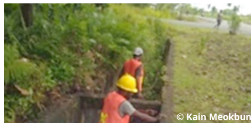
Sumber: Bahan Monitoring PPK 5.2 Gambar 3. Foto Pelaksanaan Ruas Jalan Dekai- Kenyam di Kabupaten Yahukimo
