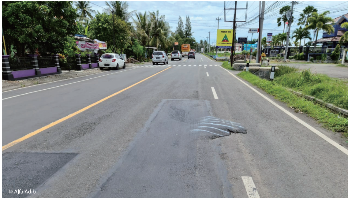
Gambar 9. Kerusakan berupa bleeding pada tambalan dengan CPHMA
