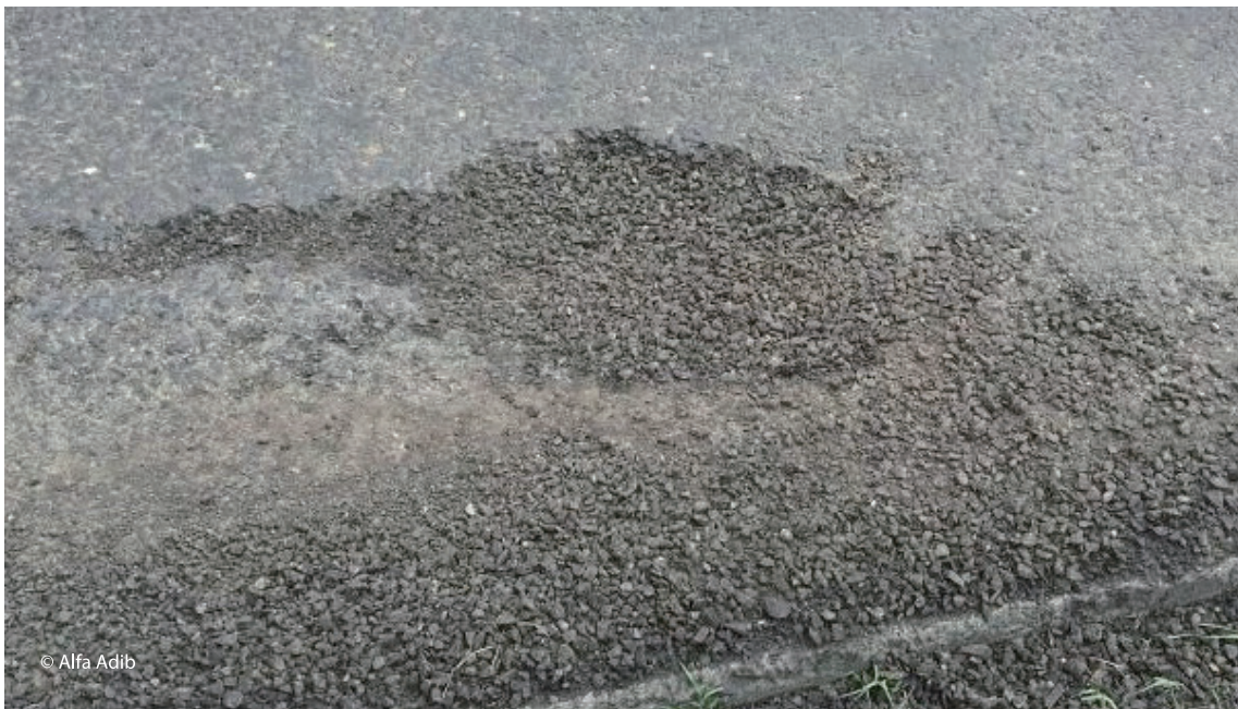
Gambar 10. Kerusakan Raveling pada Perkerasan Jalan dengan CPHMA
