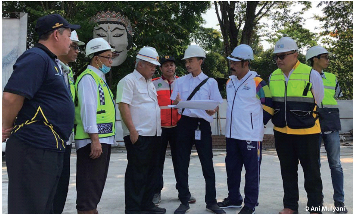
Gambar 2. Kunjungan Bapak Menteri PUPR Basuki Hadimuljono dan Walikota Solo FX Hadi Rudyatmo di Lokasi Pembangunan Flyover Manahan, Solo 2018
