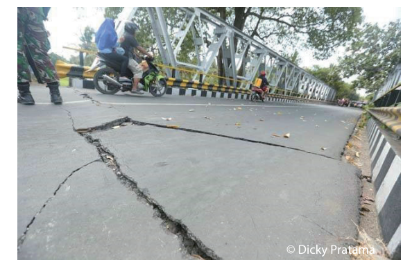
Gambar 2. Jembatan Penghubung Retak Akibat Gempa Lombok Utara Berkekuatan 6,2 SR (Sumber: https://daerah.sindonews.com ).
