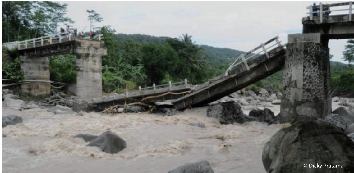
Gambar 3. Jembatan Roboh Pasca Gempa Sumba Timur, Nusa Tenggara Timur Berkekuatan 6,0 SR (Sumber: https://www.suara.com ).
