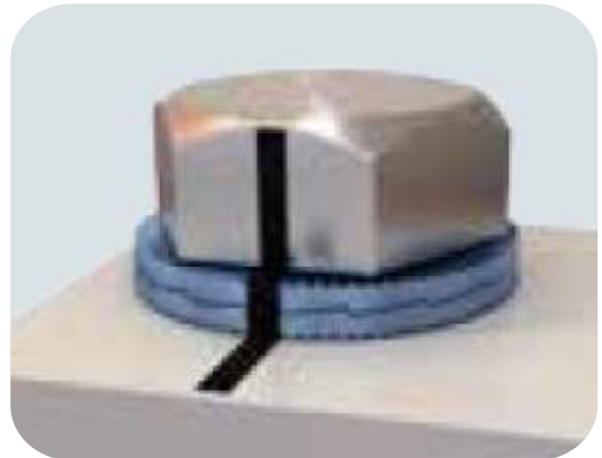
Gambar 9. Kondisi Garis Lurus antara Kepala Baut dan Badan Mur
