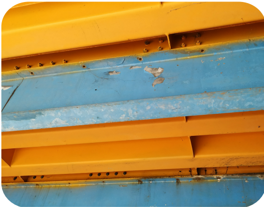
Gambar 8. Kondisi Baut pada Jembatan Citarum
