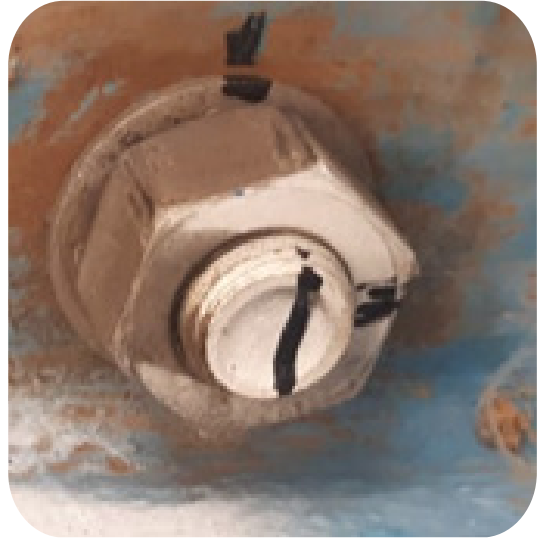
(10b) Kondisi garis torsi bergeser
