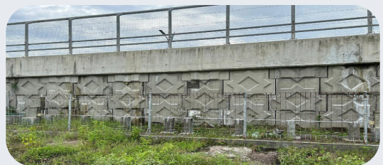
Gambar 13. Salah Satu Sensor SHMS Jembatan Kretek 2
