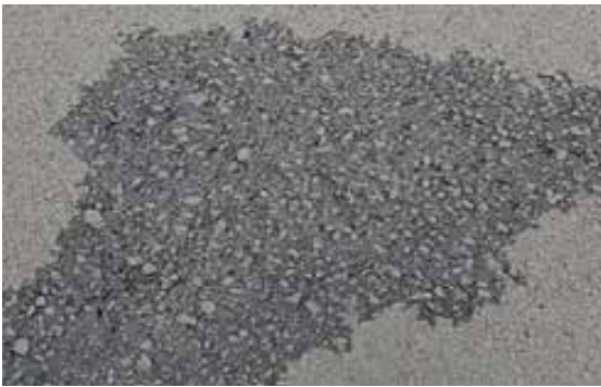
Gambar 6. Tipikal Perkerasan Jalan Asbuton B 5/20 dengan Proporsi Asbuton Terlalu Tinggi atau Temperatur Pematatan Terlalu Rendah
