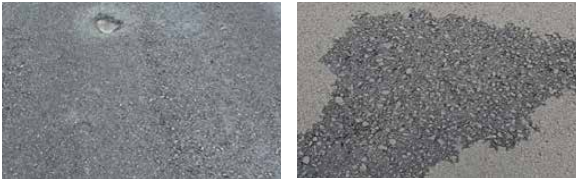
Gambar 6. Tipikal Perkerasan Jalan Asbuton B 5/20 dengan Proporsi Asbuton Terlalu Tinggi atau Temperatur Pematatan Terlalu Rendah
