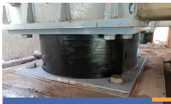
Gambar 13. LRB terpasang di jembatan Kretek 2 (sumber: Tim Bineka)
