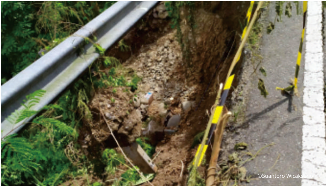
Gambar 3. Longsor pada KM 58 + 375
