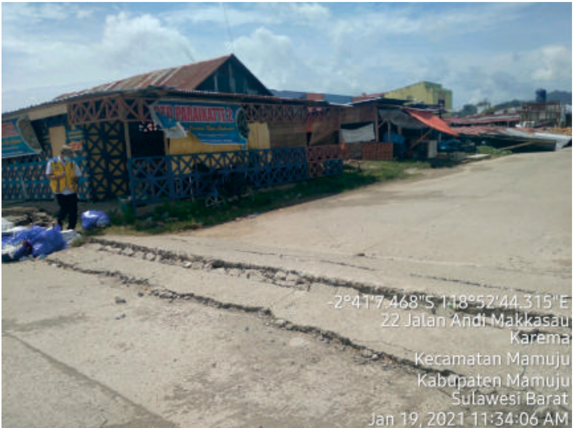
Gambar 7. Rekahan Perkerasan Badan jalan
