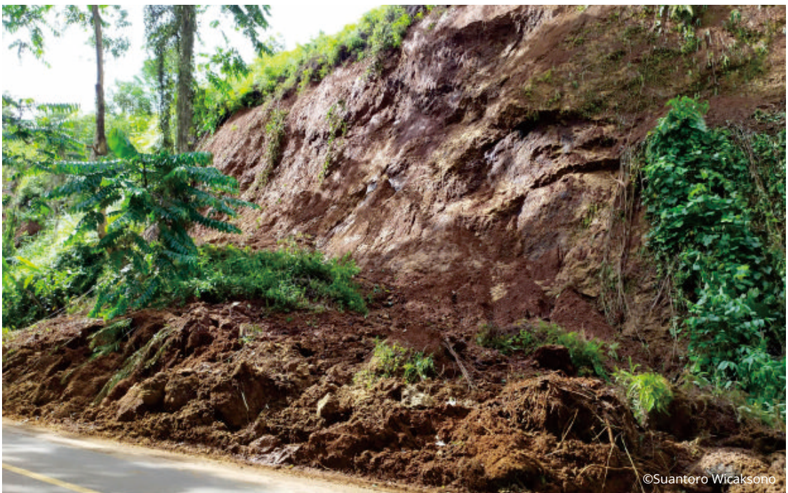
Gambar 5. Longsoran pada Lokasi KM 26 + 350
