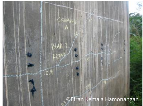
Gambar 4. Retak Struktural Pada Pilar
