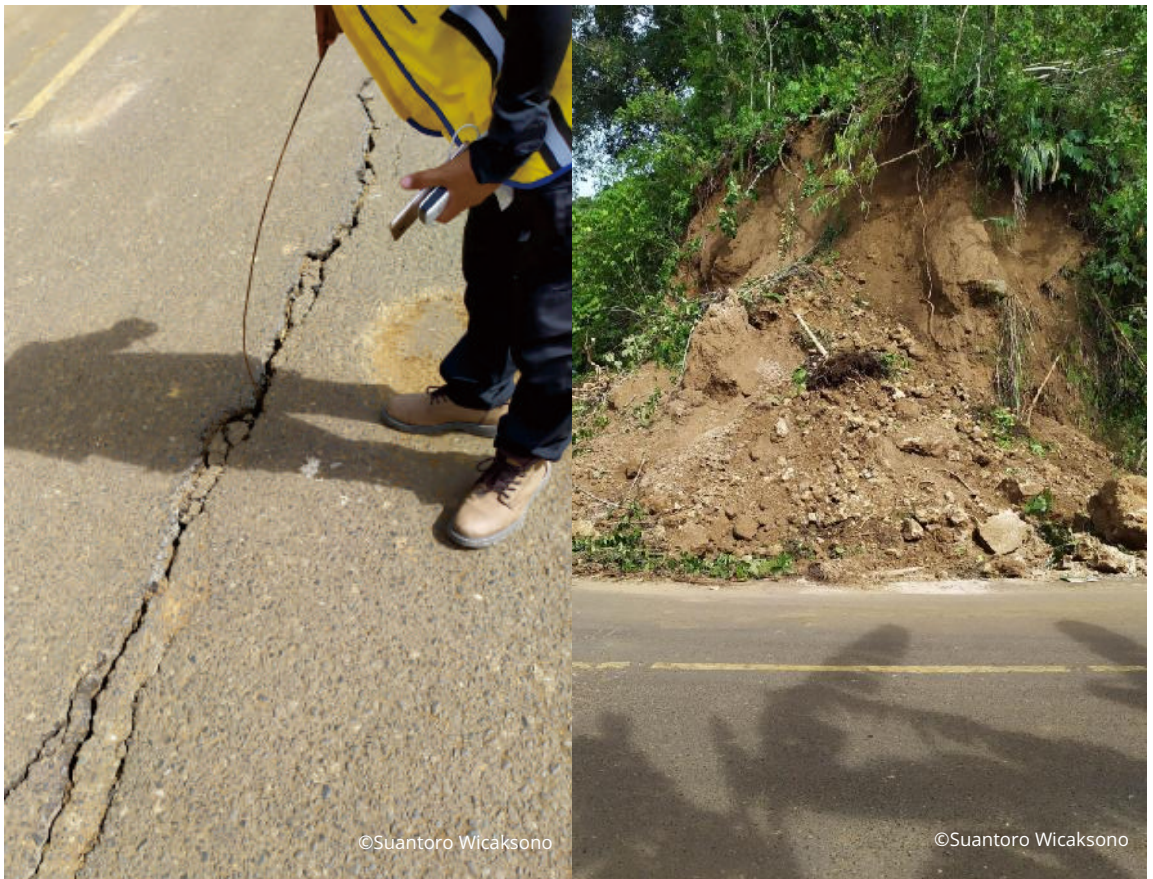
Gambar 4. Longsoran pada Lokasi KM 59 + 590
