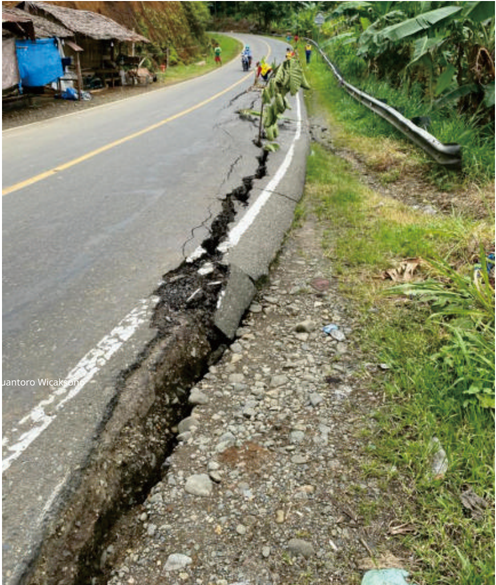
Gambar 8. Retakan Perkerasan Kaku Badan jalan
