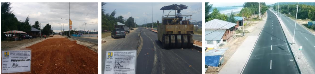
Gambar 4.6 Pembangunan Jalan Akses Jembatan Holtekamp(sisi Holtekamp) (MYC) penanganan Satker PJJN Wil. I Prov. Papua (Jayapura)
