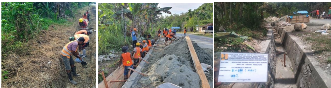
Gambar 4.19 Kegiatan Revitalisasi Drainase Pasangan Batu Mortar Jayapura-Sentani-Nimbotong penanganan Satker PJJN Wil. I Prov. Papua (Jayapura)
