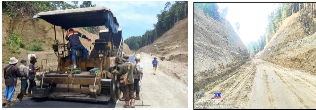
Gambar 4.4 Pembangunan Jalan Mamberamo-Elelim II (MYC) penanganan Satker PJN Wil. I Prov. Papua (Jayapura)
