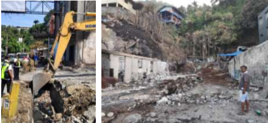
Gambar 4.4 Kerusakan yang terjadi akibat Kejadian Kerusuhan terkait isu sosial yang terjadi di Kota Jayapura Provinsi Papua pada 29 Agustus 2019
