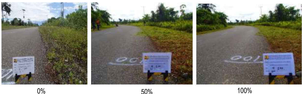
Gambar 4.10 Kegiatan Pemeliharaan Rutin Jalan Dekai-Kenyam oleh Satker PJN Wil. V Puncak Jaya
