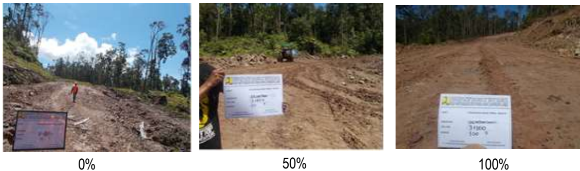
Gambar 4.22 Penurunan Grade Jalan Simpang Kapiroya - Waghete oleh Satker PJN Wil. VI Provinsi Papua (Timika)
