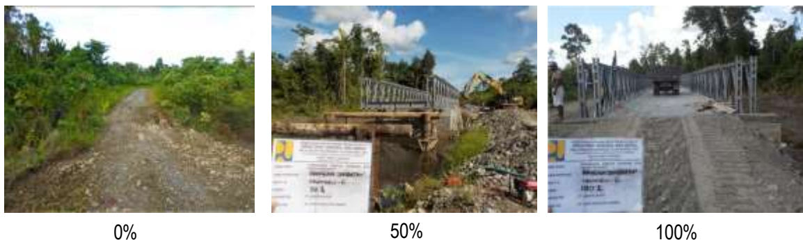
Gambar 4.26 Pembangunan Jembatan Transpanel Ruas Kenyam – Batas Batu oleh Satker PJN Wil. IV Provinsi Papua (Jayawijaya)
