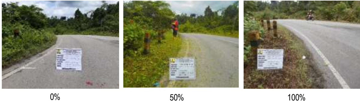
Gambar 4.5 Kegiatan Pemeliharaan Rutin Jalan Biak-Junction-Korem berupa pembabatan rumput oleh Satker PJN Wil. IX Provinsi Papua (Biak-Serui)
