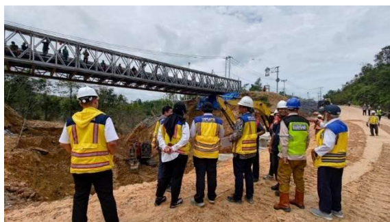
Kunjungan Lapangan Kejadian Longsor STA 29+570 Ruas Rantau Berangin – Bts. Prov. Sumbar
