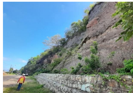
Validasi Cost Program Lereng Jalan di Ruas Jalan Nasional Ende – Maumere Nusa Tenggara Timur
